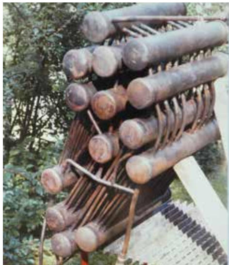
Tuberna i vattenrörspannan.
