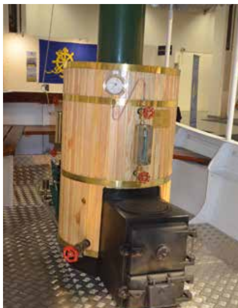
Ångpanna av fabrikat Breeding 35 kW.
